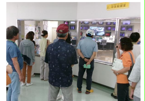
渡刈クリーンセンター・中央制御室
