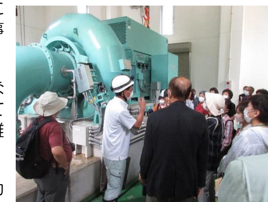
小水力発電施設
