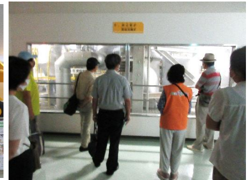
⑤ 熱分解炉・燃焼溶鉱炉の前では、分厚いガラスにおおわれていますが熱を感じました。
